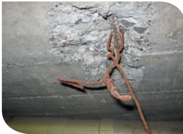
Ejemplo de problema patológico derivado de mal mantenimiento y utilización.
