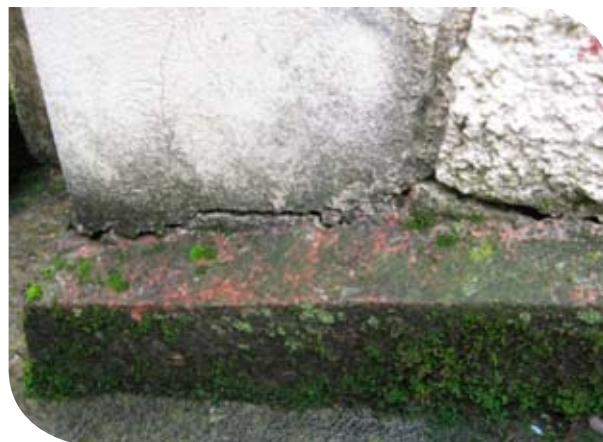
Ejemplo de problemas patológicos, fisura en este caso, de una de las edificaciones de la Universidad.
